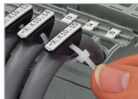
Прикрепите маркировочную манжету (211-129) к отдельным кабелям или проводникам при помощи кабельных стяжек (807-090/101-100).
