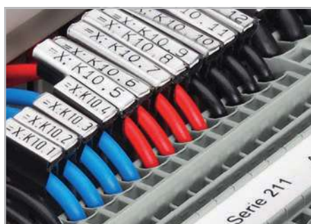
Маркировка проводников с помощью маркировочных манжет.
