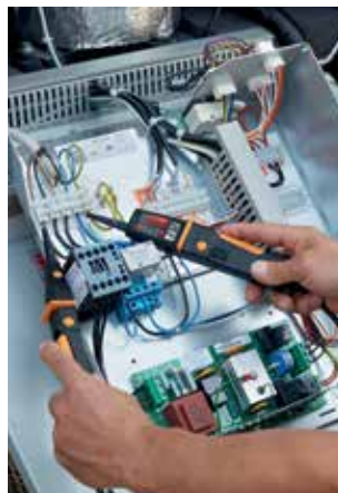
Измерение напряжения на компрессоре.
