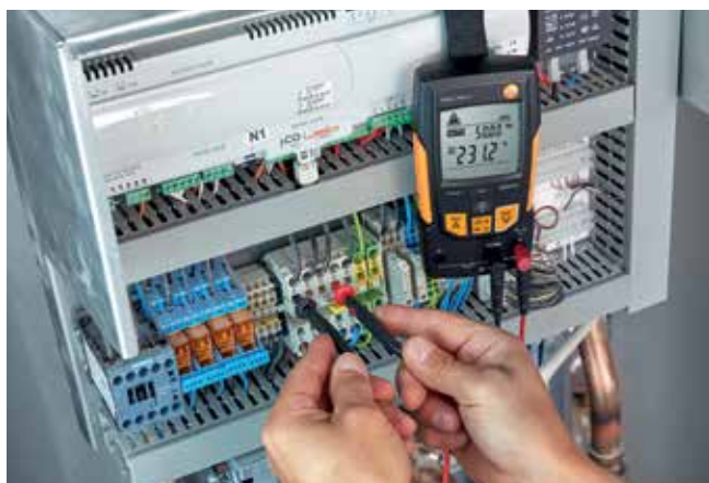
Проверка напряжения в распределительном щитке теплового насоса.
