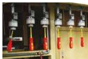
Indywidualne testy pod napięciem. Individual tension tests.
